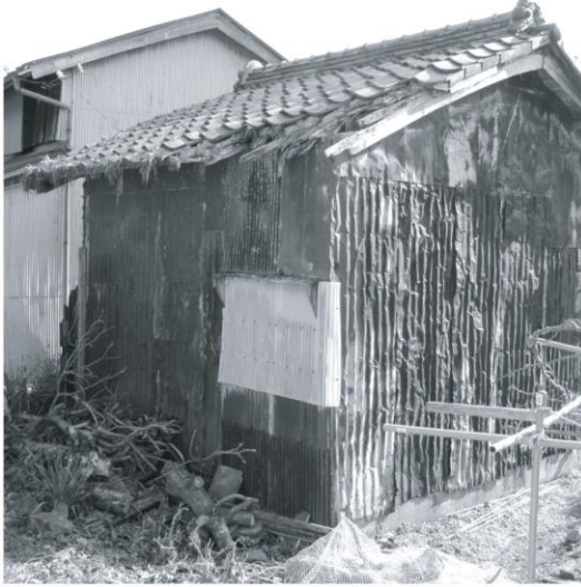
老朽化した空き家
