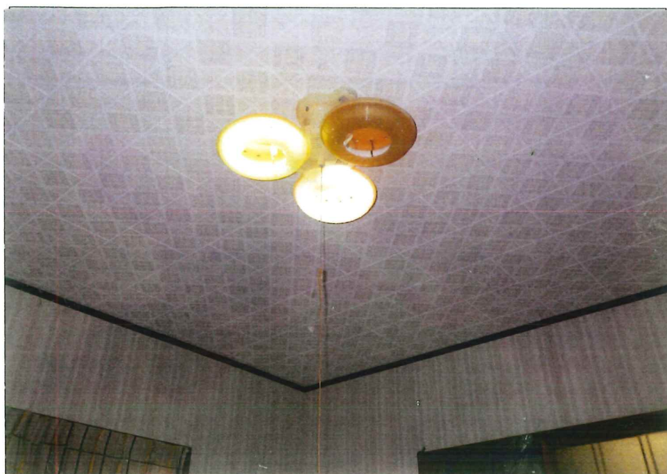
照明器具の不良
