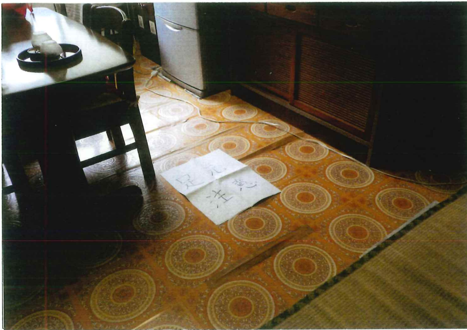
4-① 床仕上材の劣化 D・K
