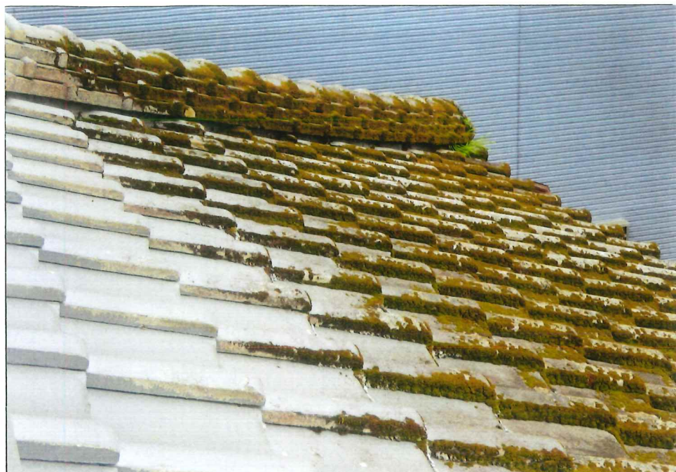
3-① 屋根瓦の劣化
