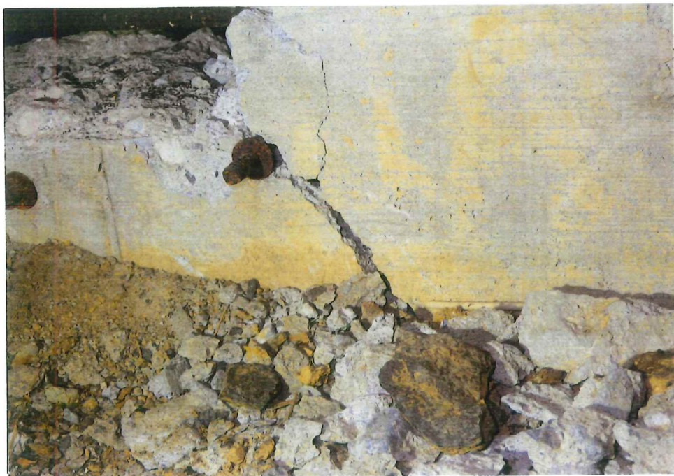
2-① 地盤の沈下による基礎の割れ。
