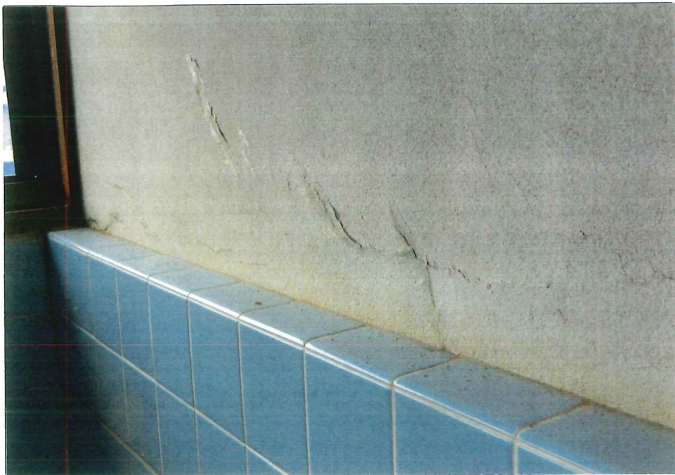
4-③ 浴室壁の劣化
