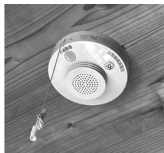
住宅設置の火災報知器
