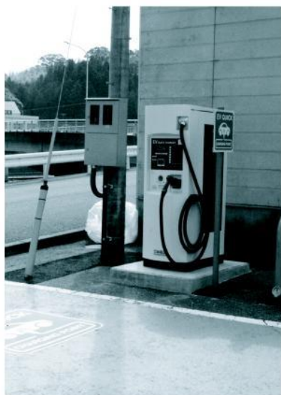
ポルト駐車場に設置された電気自動車急速充電器
