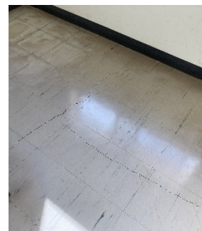
老朽化した廊下
