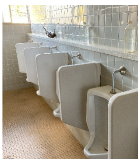
水栓機能のないトイレ
