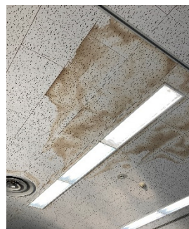
雨漏りしている室内
