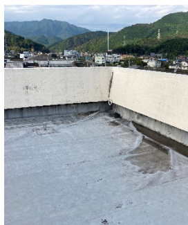
改善の必要な屋上
