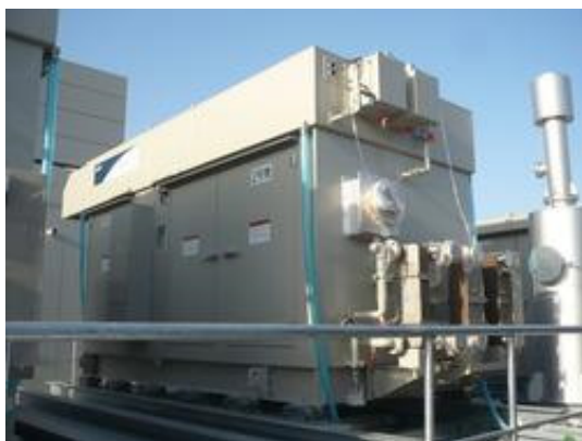
非常用発電機(浦安市 HP)
