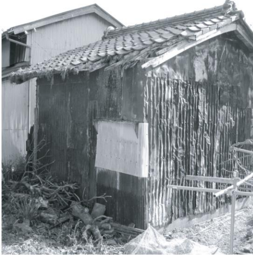
老朽化した空き家
