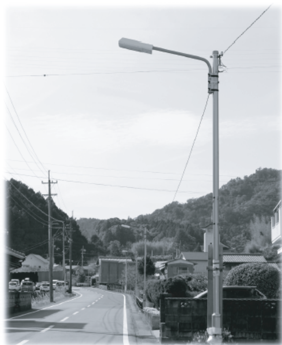
LED化した街路灯
