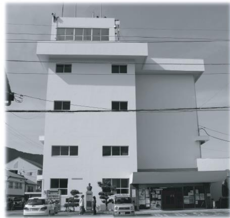
老朽化が進む役場庁舎
