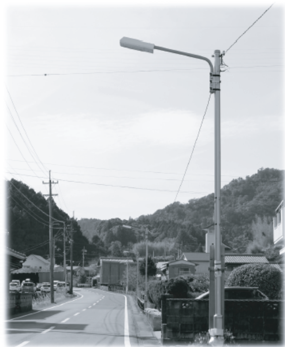
LED化した街路灯
