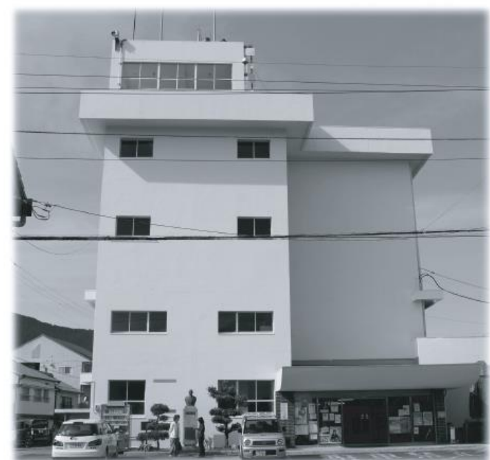
老朽化が進む役場庁舎
