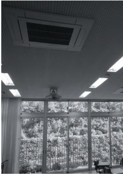
エアコンが設置された小学校の教室
