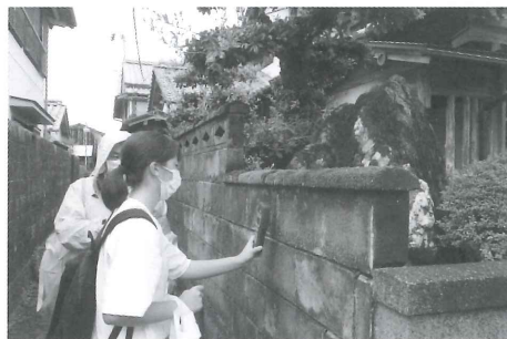
ブロック塀調査 (地域の安全確保モデル事業)
