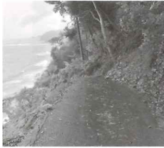
町道灘線寸断
